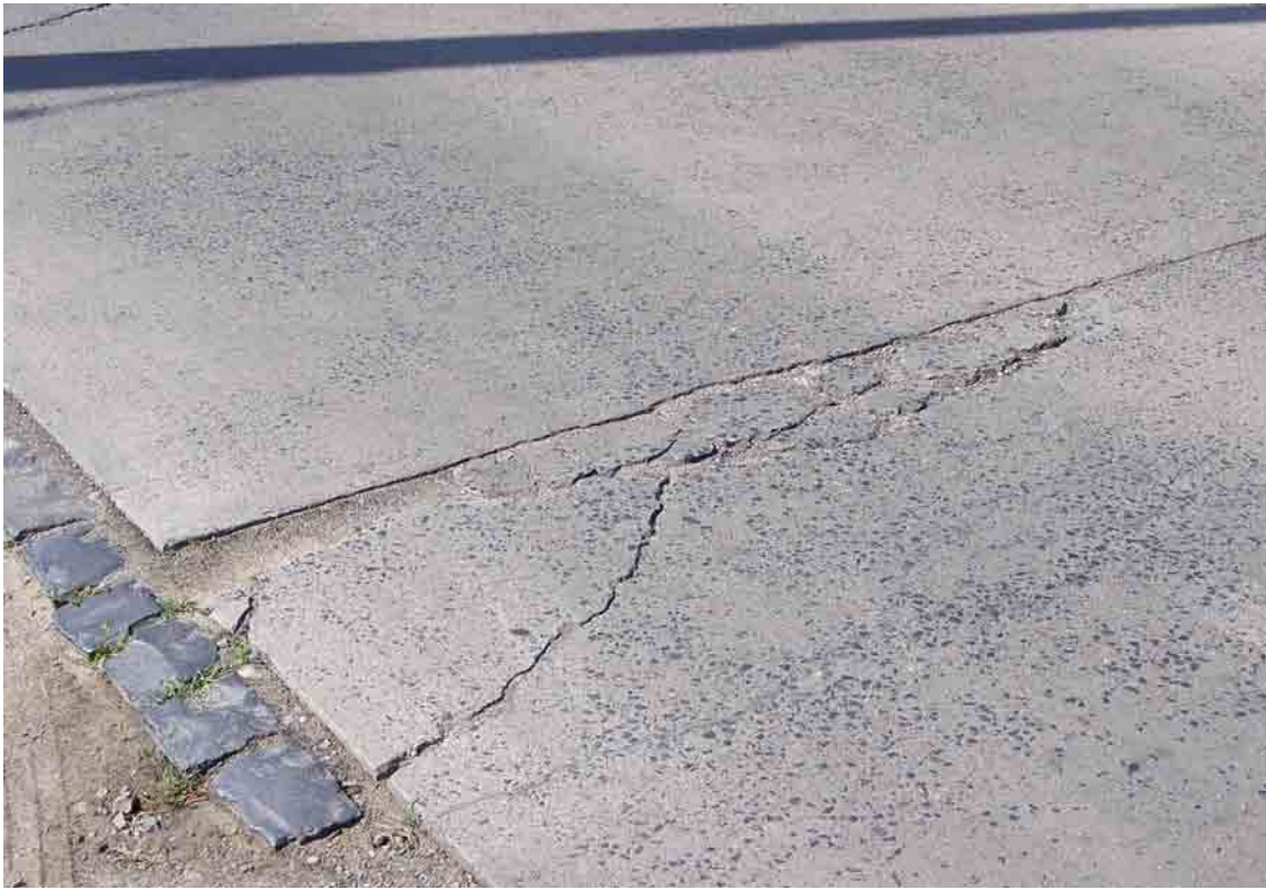
Fot. 26. Pęknięcie przy krawędzi połączone z uszkodzonym narożnikiem (PK) (UN)
