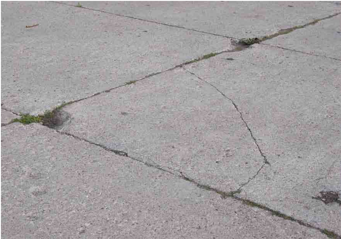
Fot. 44. Pęknięcie narożnika o dużej szkodliwości (UN)
