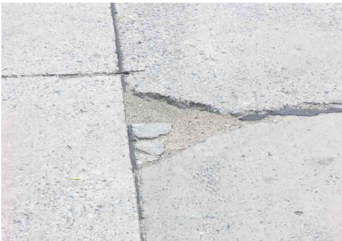
Fot. 45. Uszkodzone narożniki przyległych płyt (UN)
