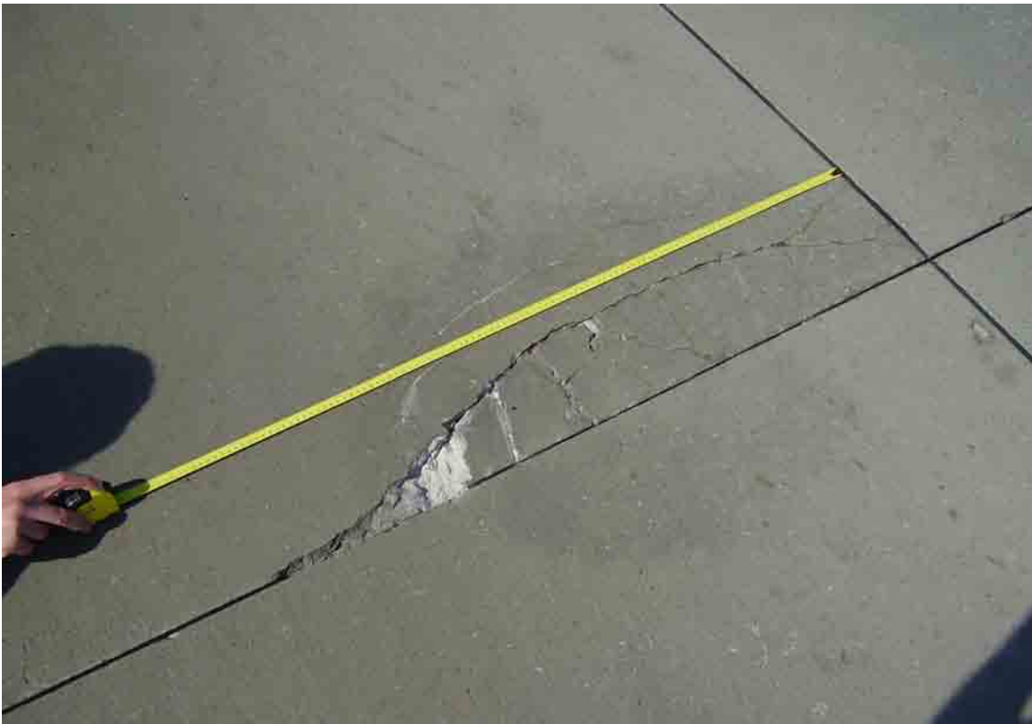
Fot. 21. Pęknięcie przy krawędzi o dużym stopniu szkodliwości ( PK )
