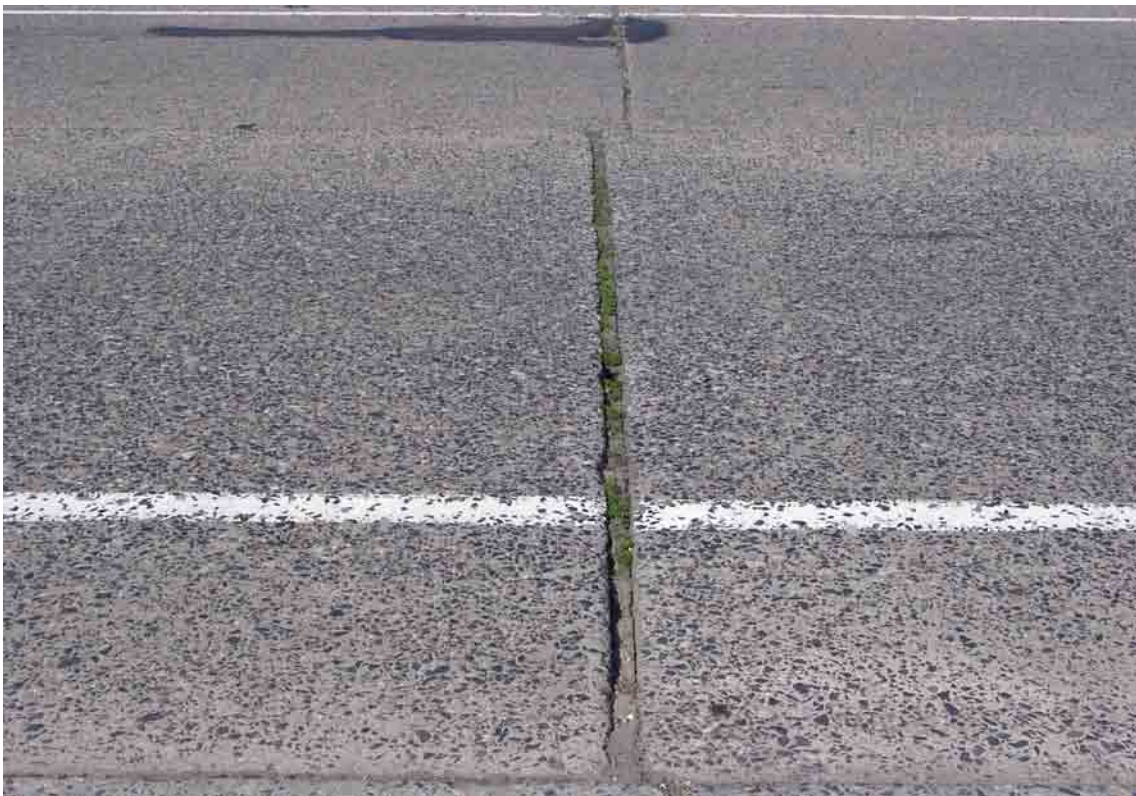
Fot. 35. Uszczelnienie szczeliny porośnięte roślinnością (WU)
