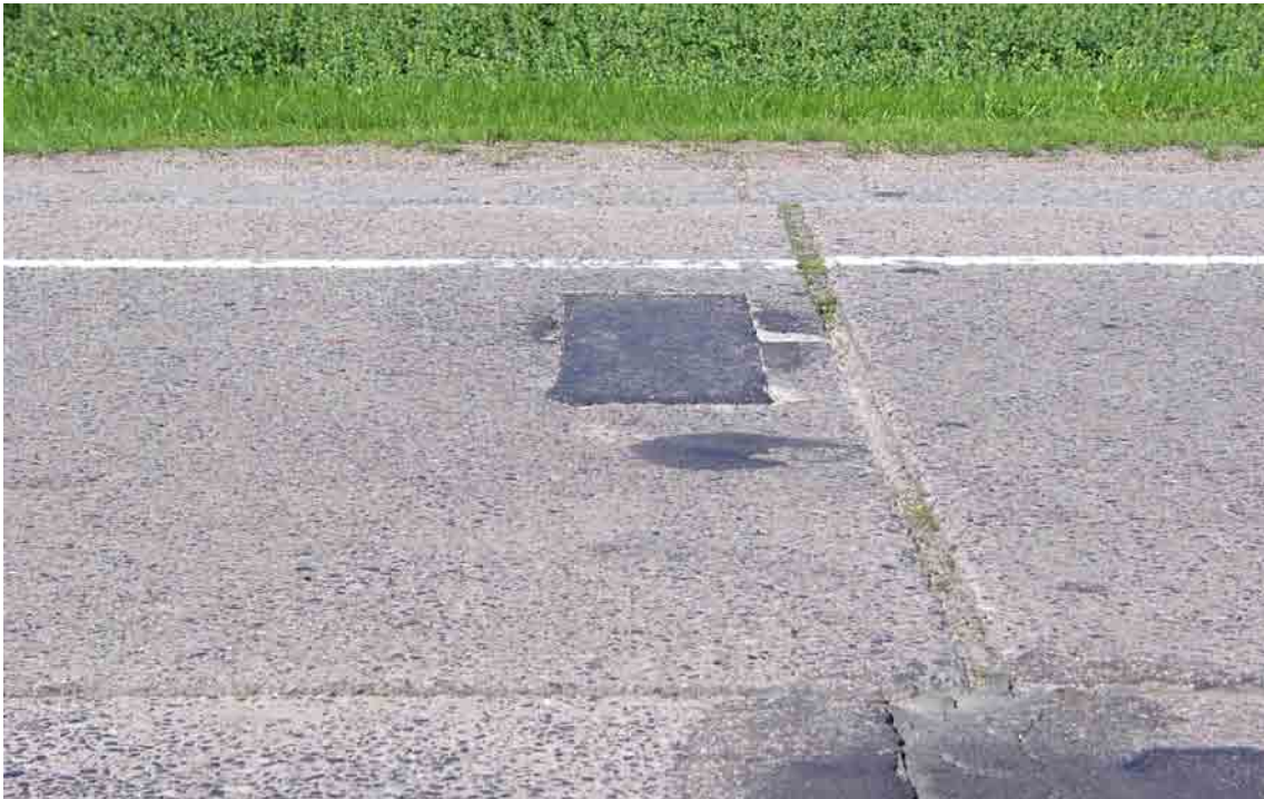
Fot. 65. Przykład łaty bitumicznej wewnątrz płyty (LA)
