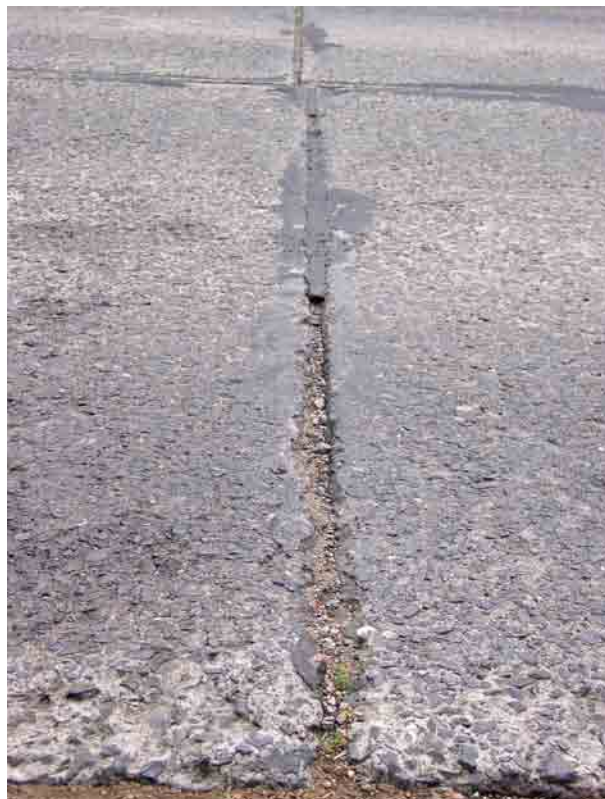
Fot. 37. Częściowo wykruszone uszczelnienie bitumiczne (WU)
