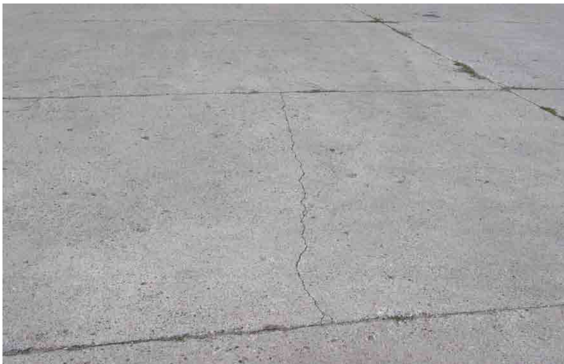
Fot. 1. Pęknięcie podłużne małej szkodliwości (PL)
