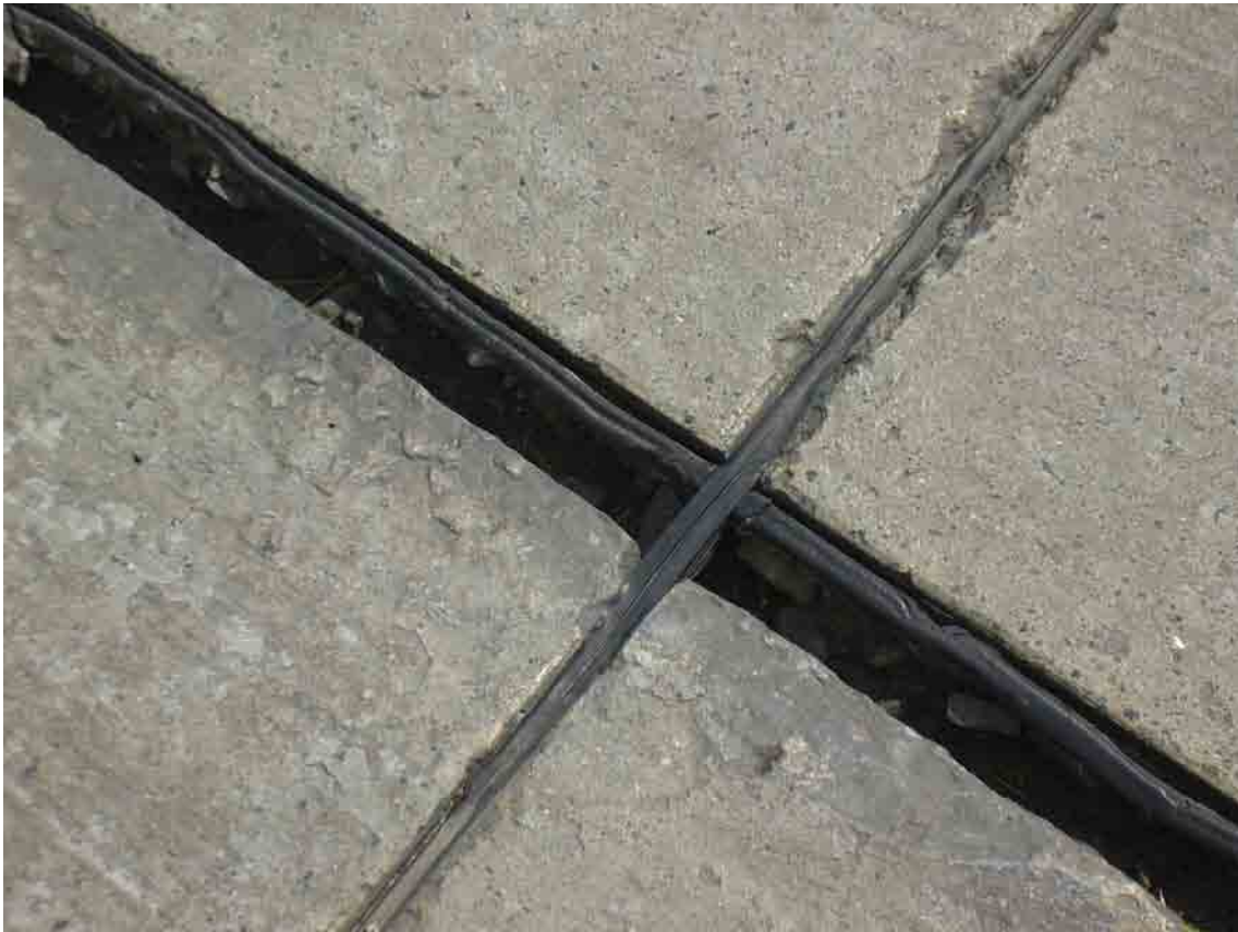
Fot. 34. Rozsunięcie się płyt powodujące odklejenie uszczelnienia (WU)
