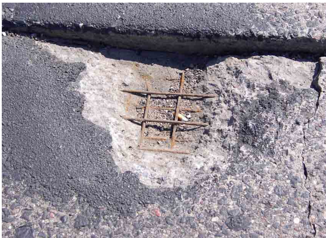
Fot. 30. Znaczne wykruszenia przy krawędzi płyty odsłaniające siatkę zbrojenia (UZ)
