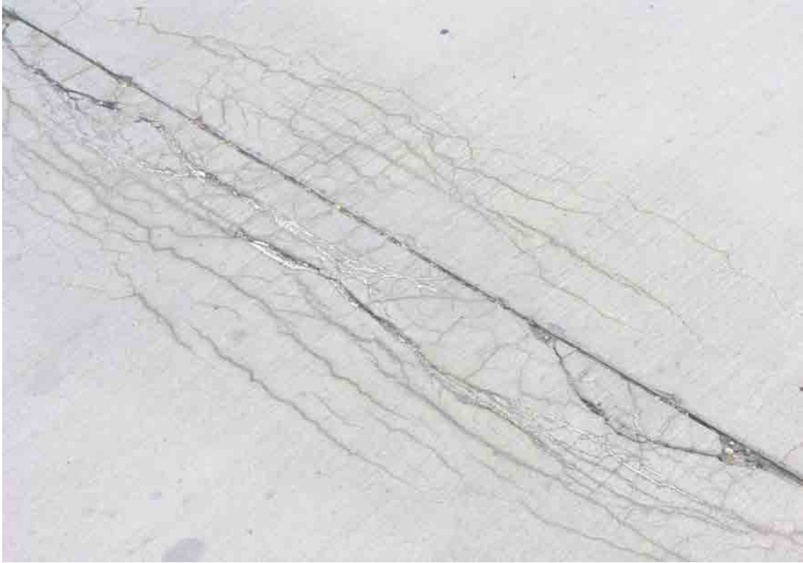
Fot. 22. Przykład pęknięć przy krawędzi o dużej szkodliwości ( PK )
