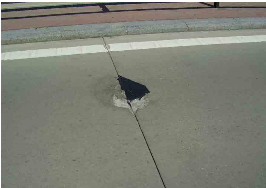
Fot. 52. Wykruszenie szczeliny powodujące powstanie wyboju pomiędzy dwiema przylegającymi płytami (WS)
