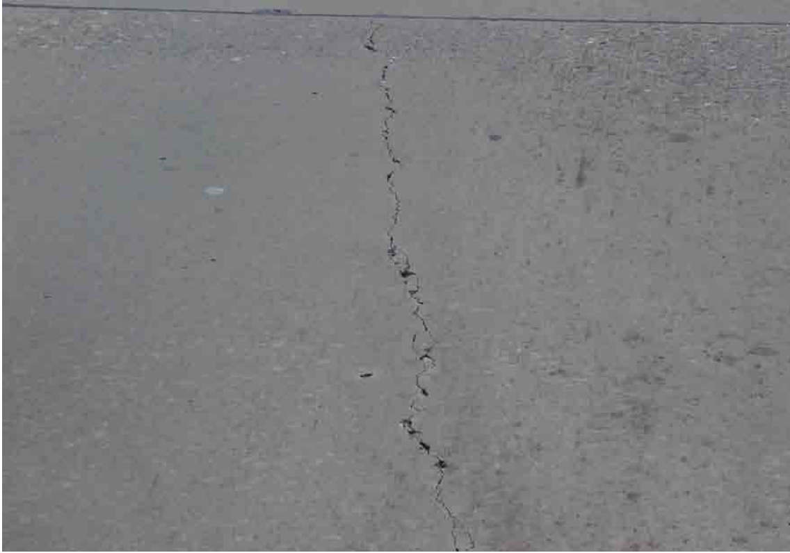
Fot. 6. Przykład pęknięcia ukośnego o dużej szkodliwości (PL)
