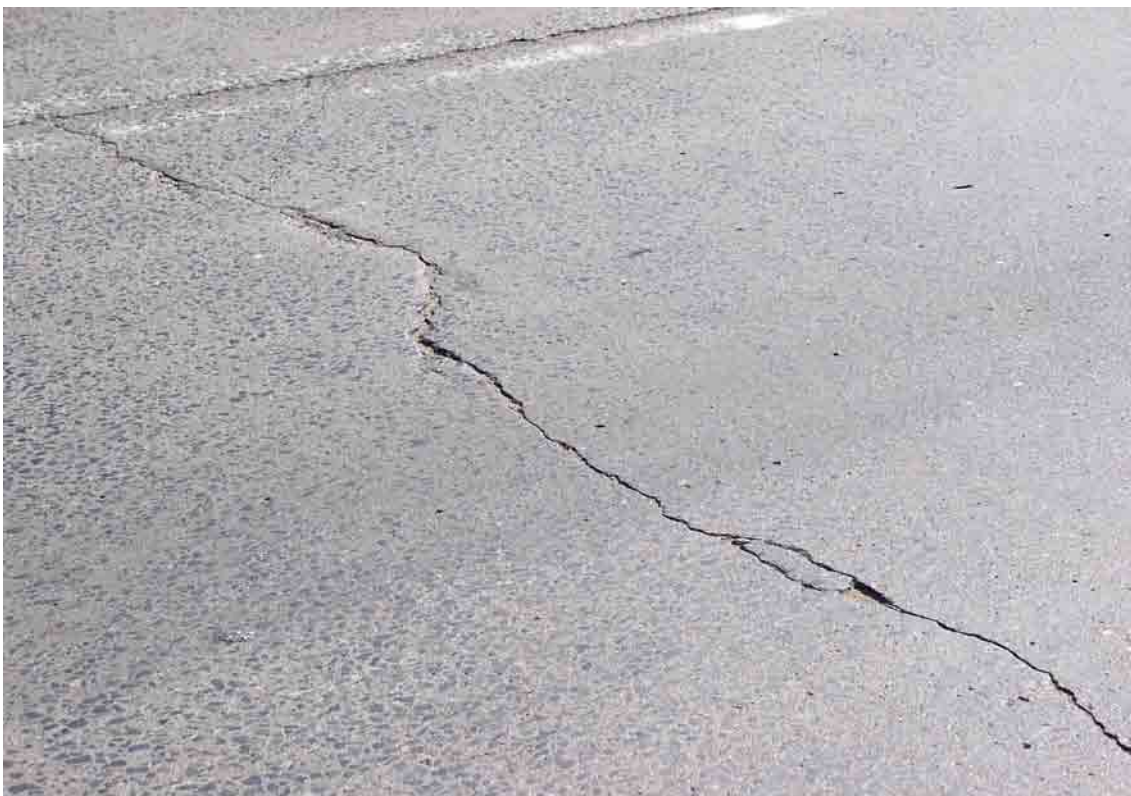
Fot. 11. Pęknięcie poprzeczne o dużym stopniu szkodliwości (PT)
