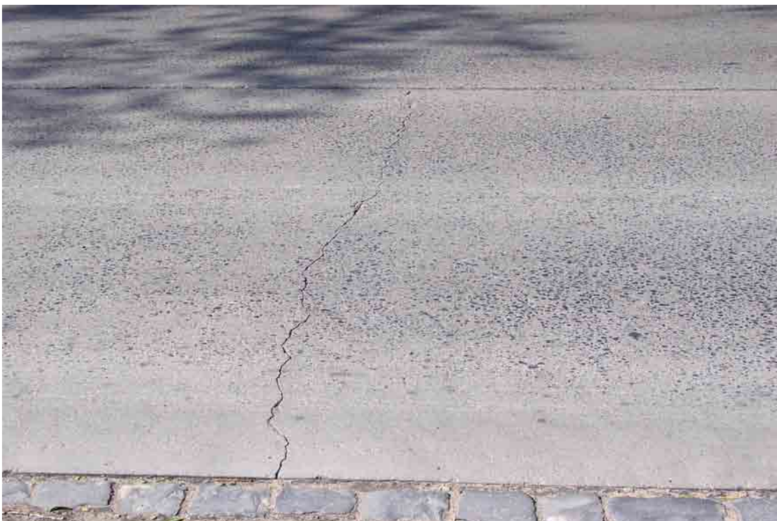
Fot. 9. Pęknięcie pojedyncze poprzeczne o małym stopniu szkodliwości (PT)
