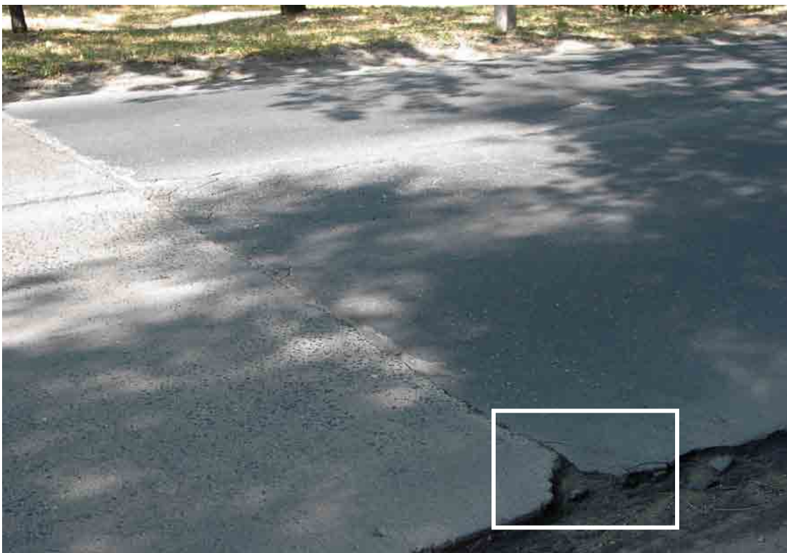
Fot. 43. Wykruszone narożniki w przyległych płytach (UN)
