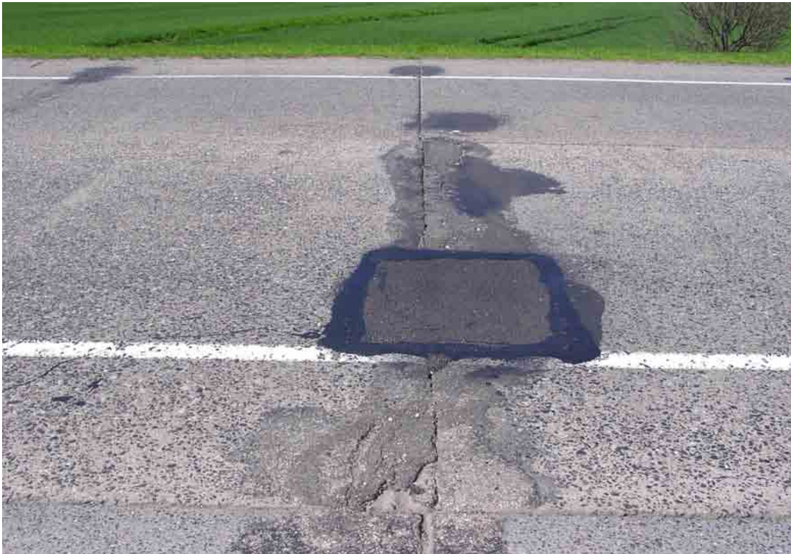
Fot. 69. Łata bitumiczna pokrywająca uszkodzenia na dwóch przylegających płytach (LA)
