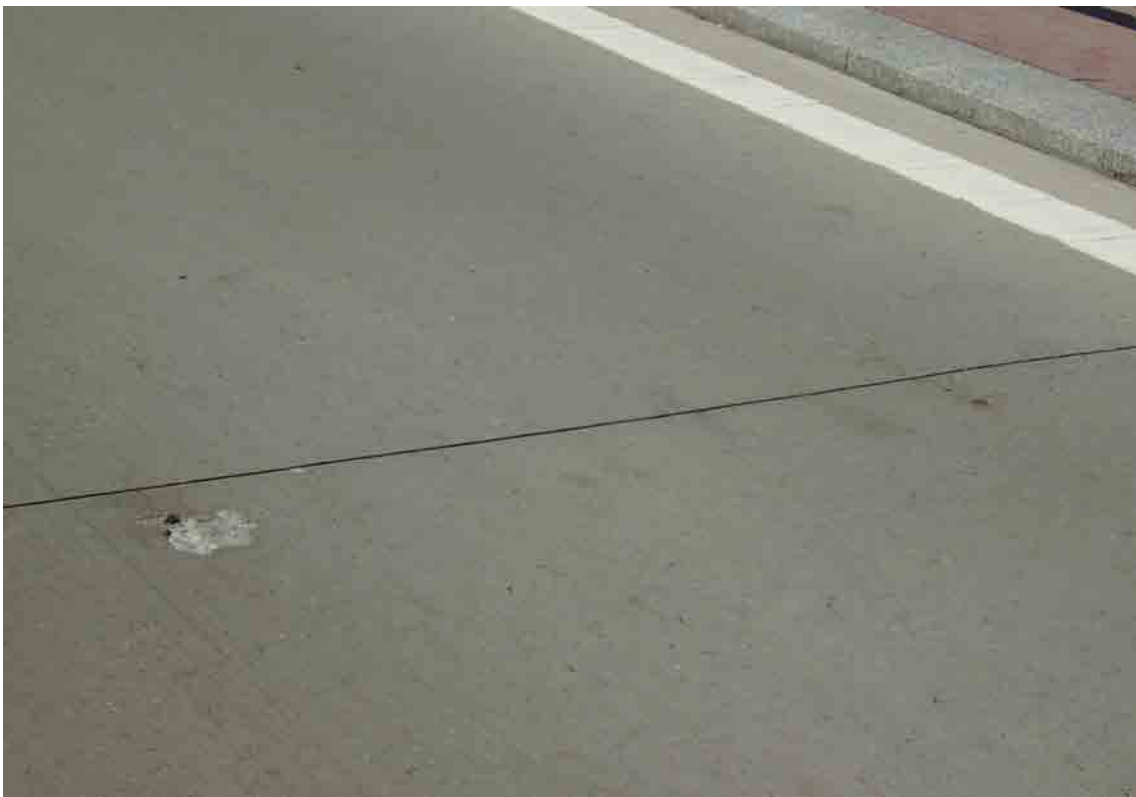
Fot. 63. Miejscowy ubytek w powierzchni płyty (UP)
