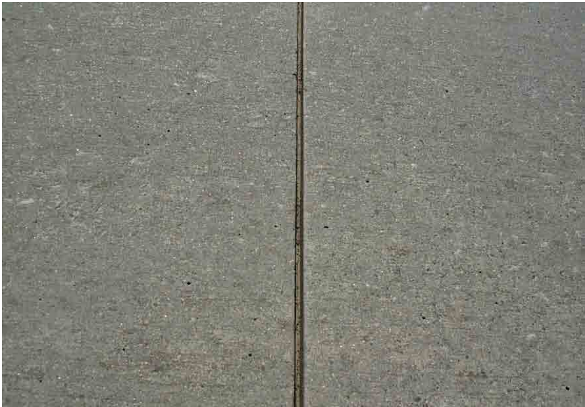
Fot. 31. Przykład początku procesu rozsuwania się płyt wraz z odklejonym elementem uszczelniającym (WU)
