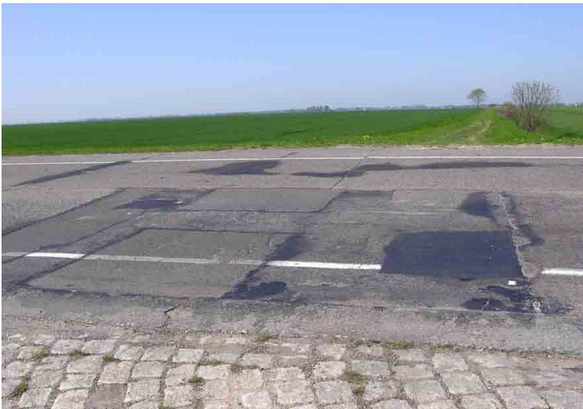
Fot. 68. Fragment nawierzchni betonowej pokrytej licznymi łatami (LA)
