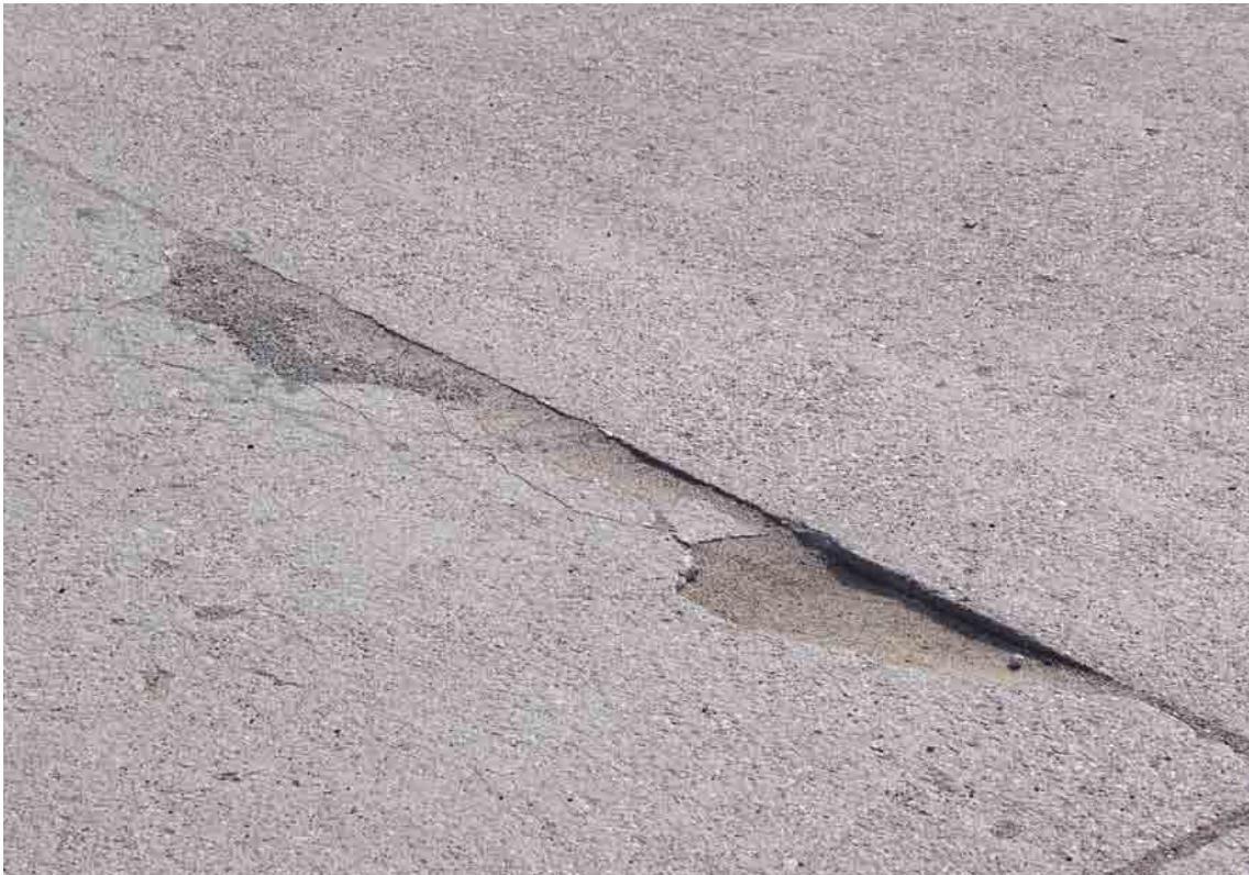
Fot. 24. Spękania przy krawędzi z wykruszeniami powodującymi powstanie wyboju ( PK )
