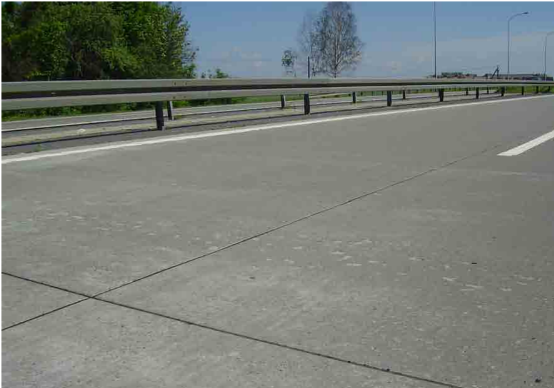
Fot. 62. Ubytki przechodzące przez dwie przyległe płyty (UP)
