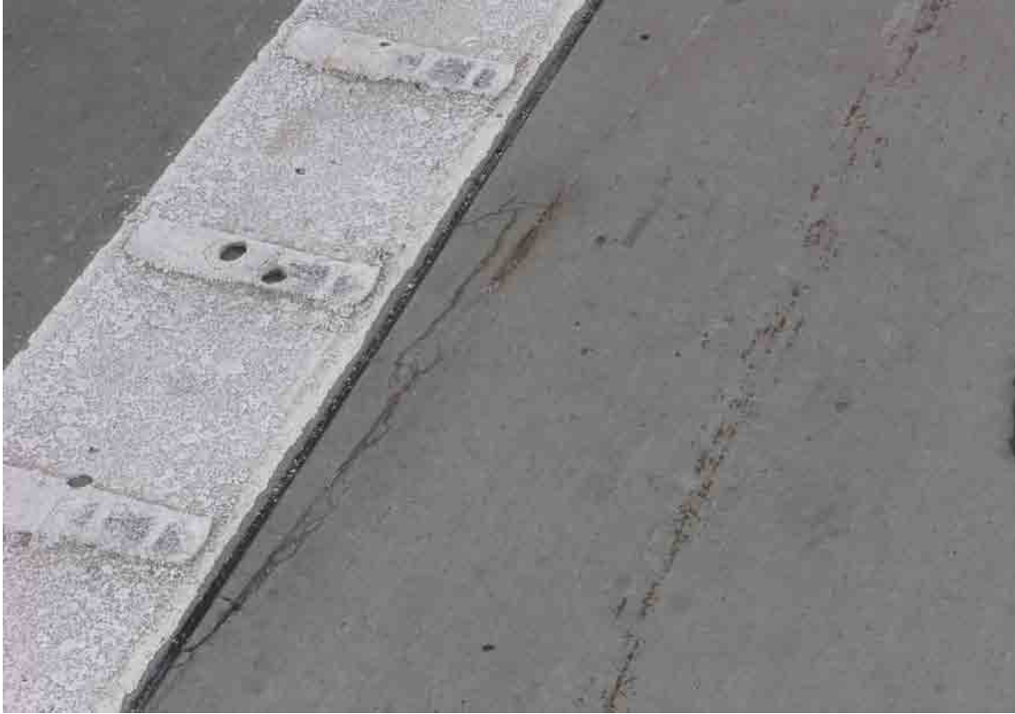
Fot. 20. Pęknięcie przy krawędzi spełniające kryteria małej szkodliwości ( PK )
