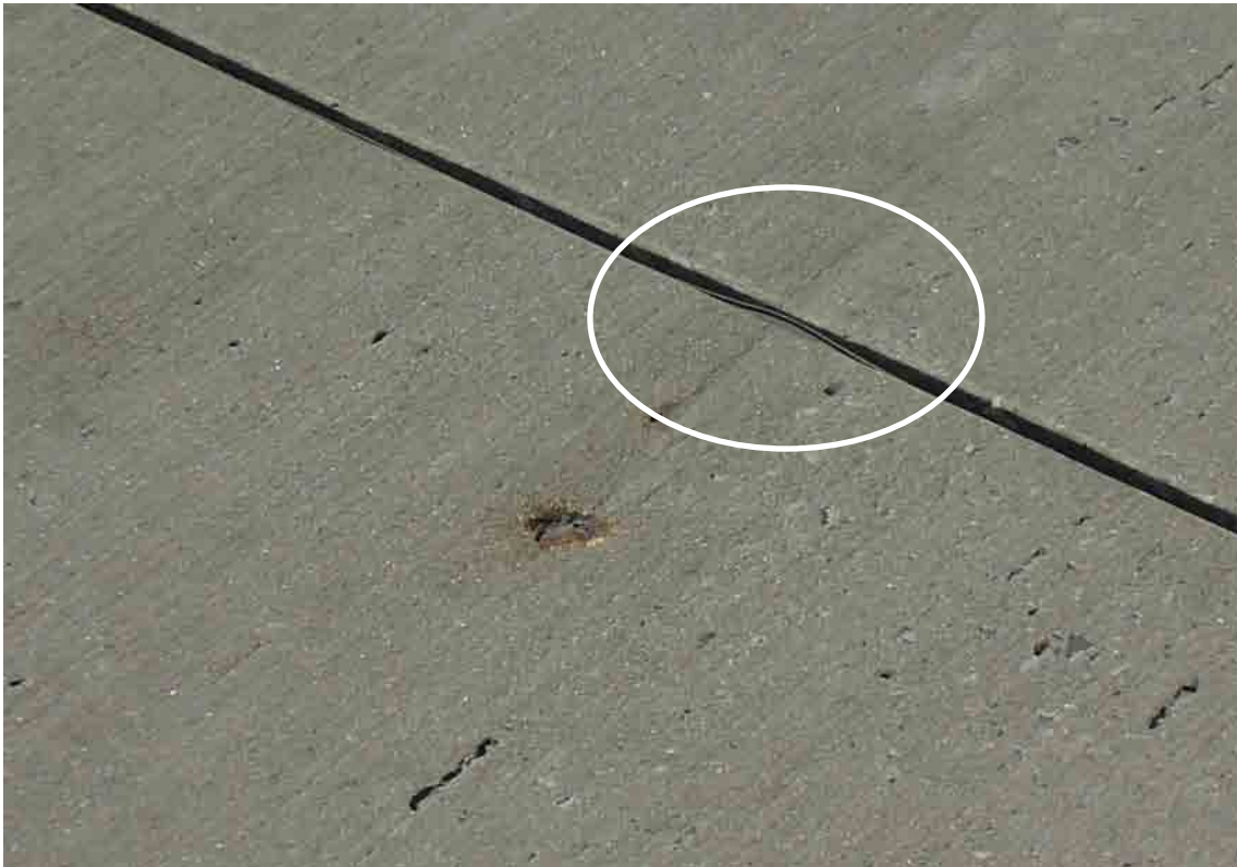
Fot. 32. Przykład początkowego stadium odklejania uszczelnienia (WU)
