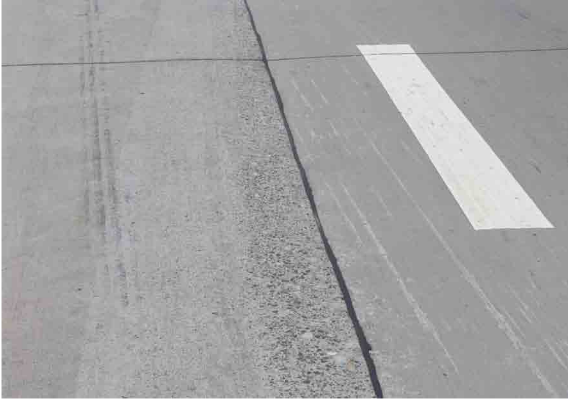
Fot. 64. Ubytki wzdłuż krawędzi płyty (UP)
