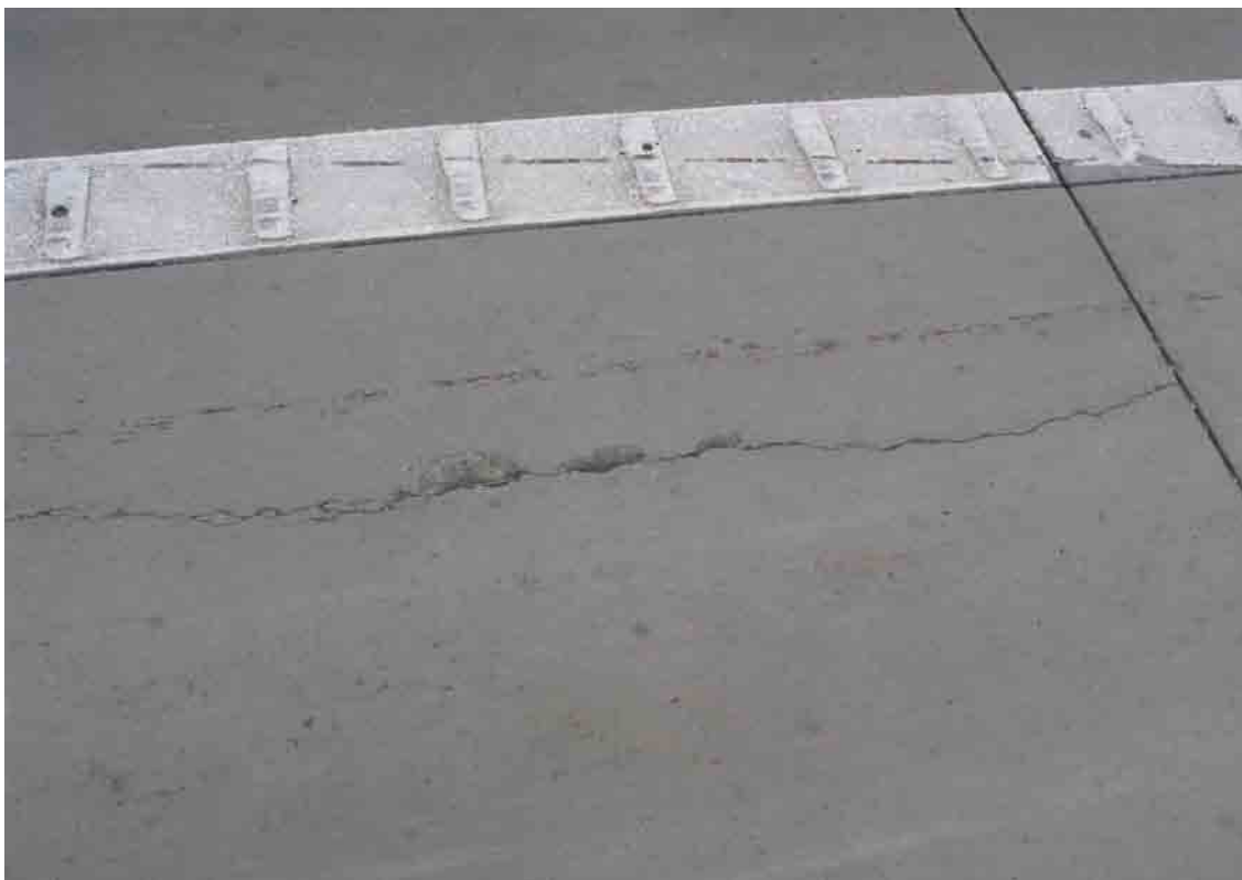
Fot. 8. Pęknięcie podłużne o dużej szkodliwości z licznymi wykruszeniami (PL)
