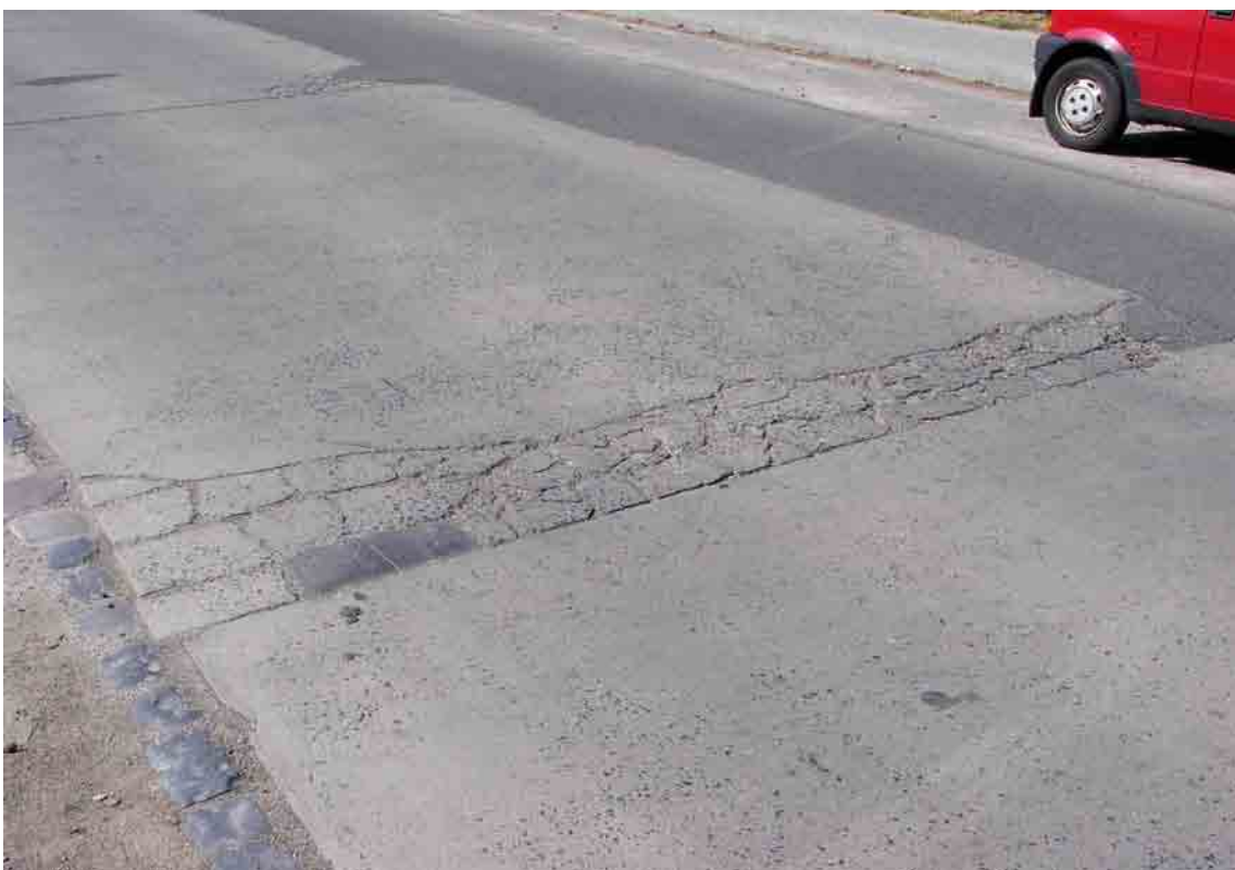
Fot. 25. Pęknięcia przy krawędzi o dużym stopniu szkodliwości ( PK )
