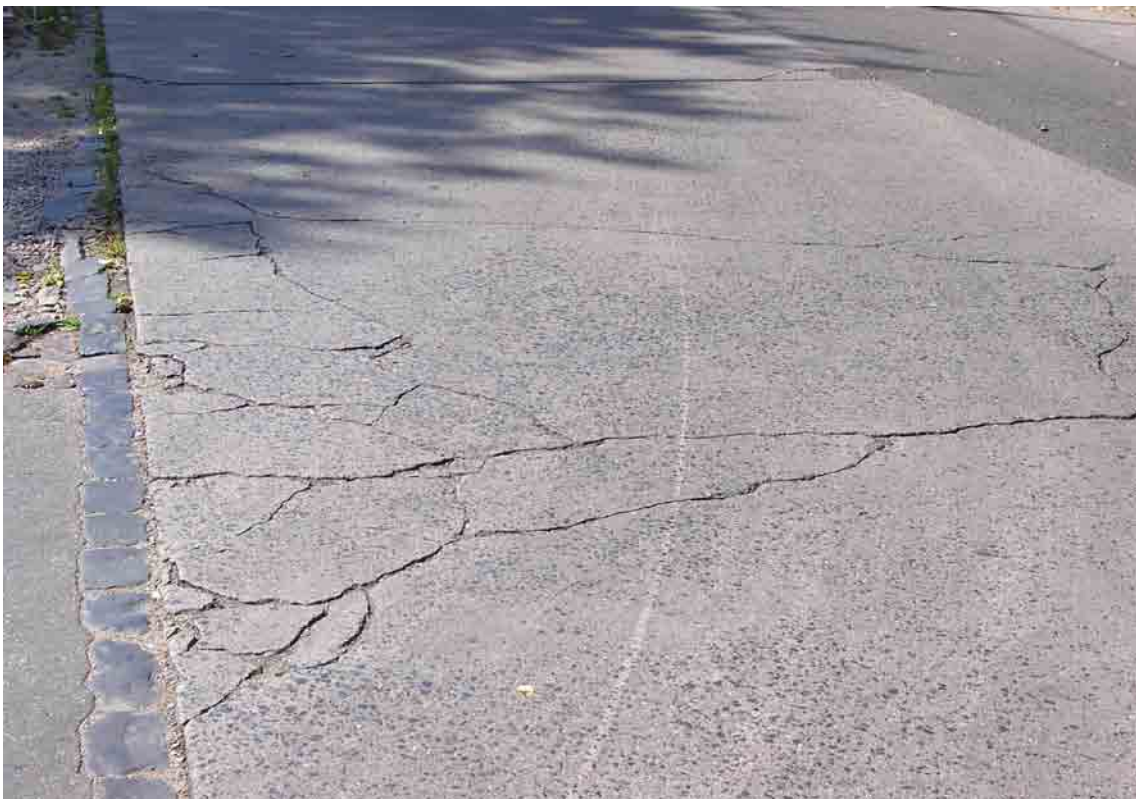
Fot. 17. Połamana płyta – liczne pęknięcia o dużej szkodliwości (BS)
