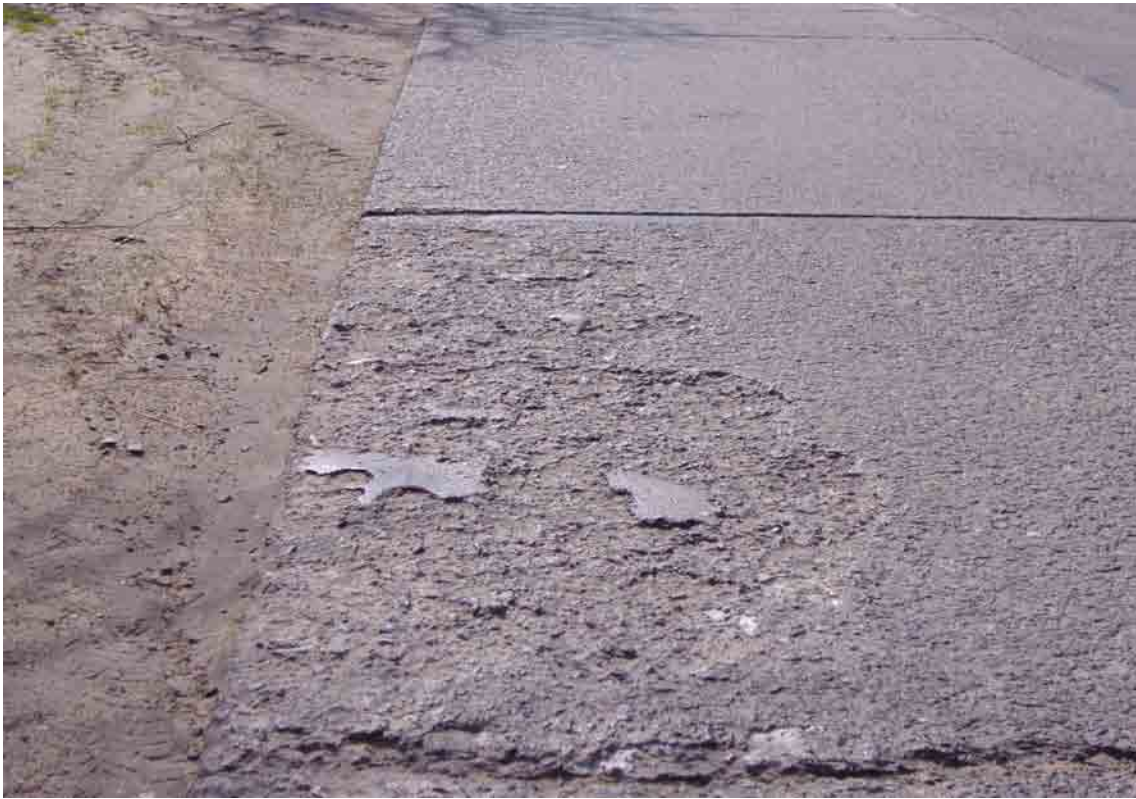
Fot. 60. Złuszczenie powierzchni płyty (UP)
