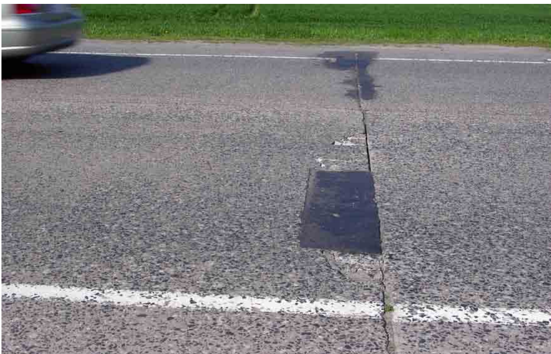
Fot. 66. Łata najprawdopodobniej przykrywająca spękania przy krawędzi płyty (LA)
