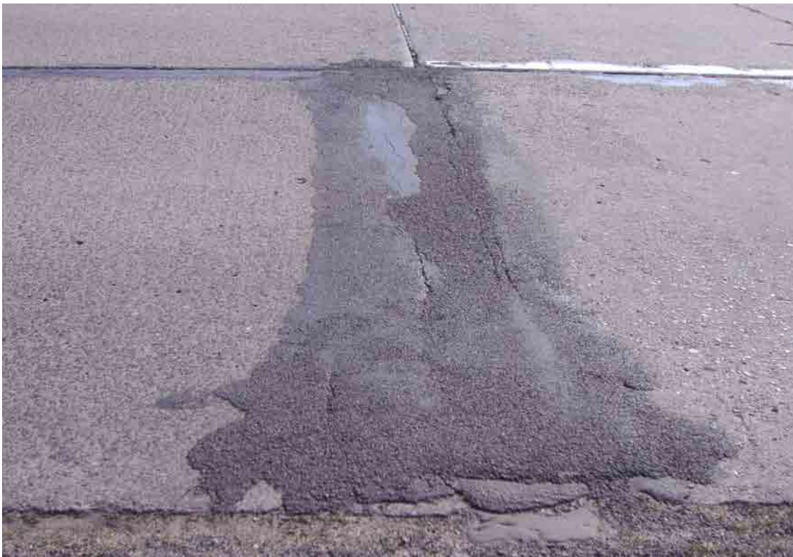
Fot. 19. Pęknięcia przy krawędzi pokryte łąką bitumiczną spod której wyłaniają się kolejne pęknięcia (PK)
