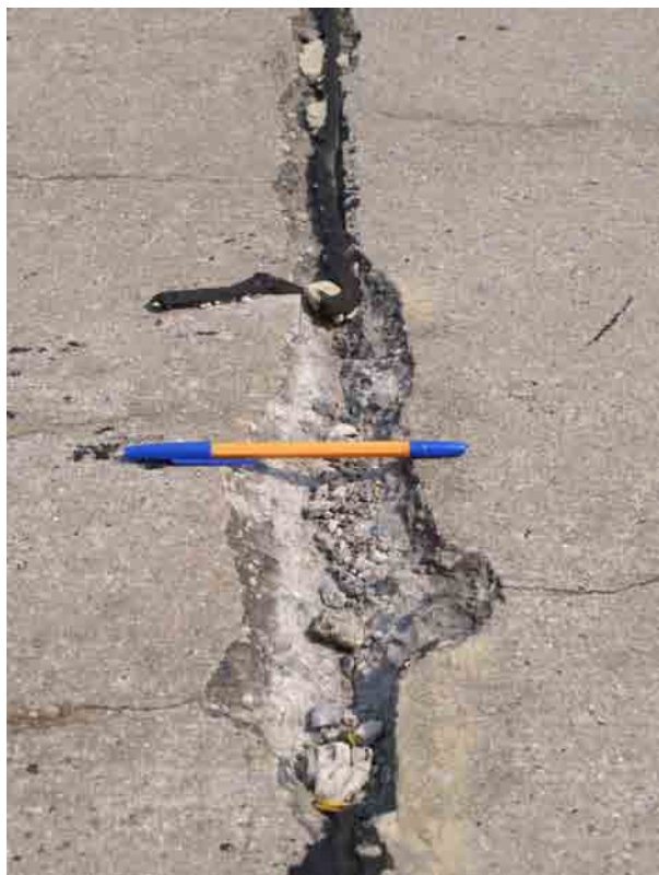
Fot. 53. Silnie wykruszona szczelina z dużą ilością luźnych fragmentów (WS)
