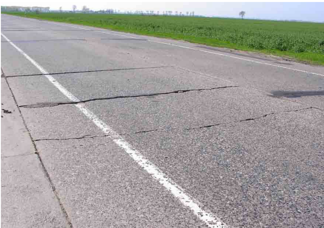
Fot. 12. Dwa równoległe pęknięcia poprzeczne dzielące płytę na trzy części (PT)
