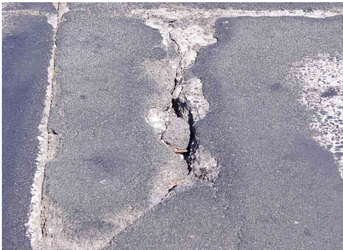
Fot. 29. Kolejny przykład odsłoniętego zbrojenia (UZ)
