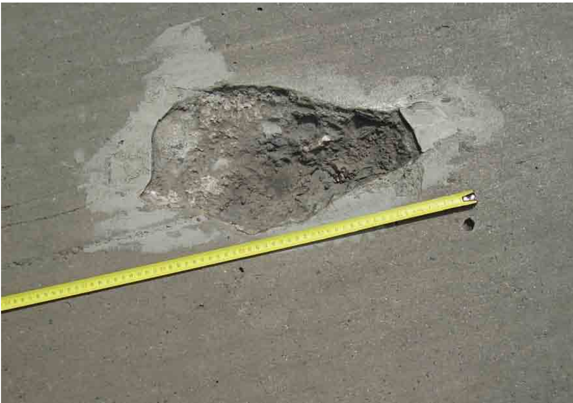
Fot. 57. Wybój na nawierzchni betonowej (UP)
