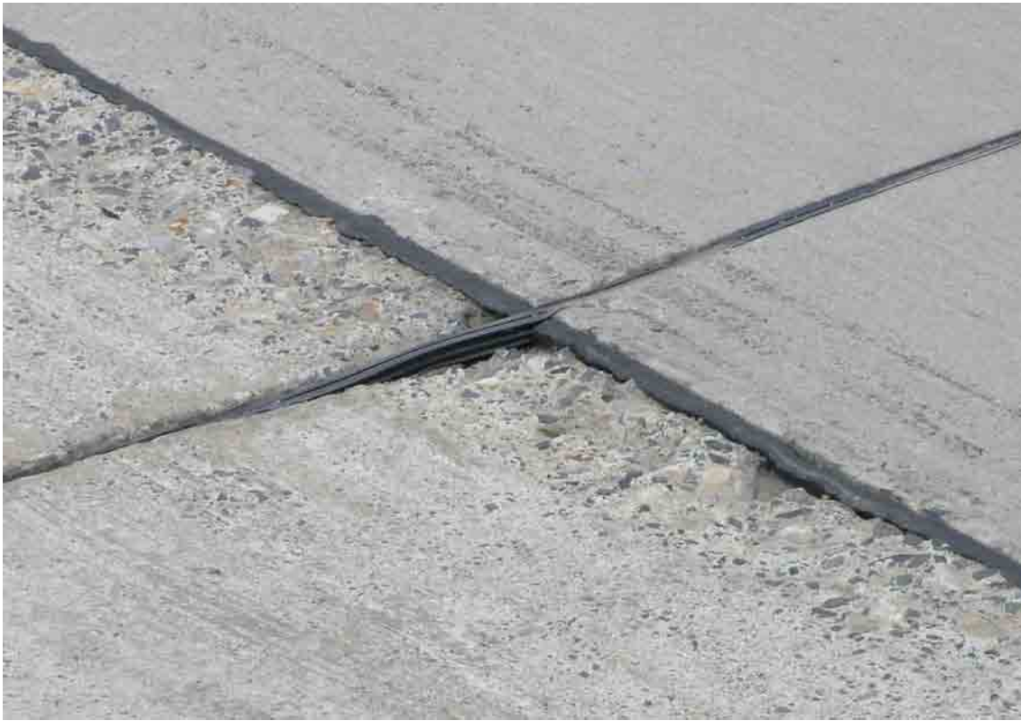
Fot. 56. Uszczelnienie odklejone w wyniku uszkodzeń powierzchni płyty (UP)
