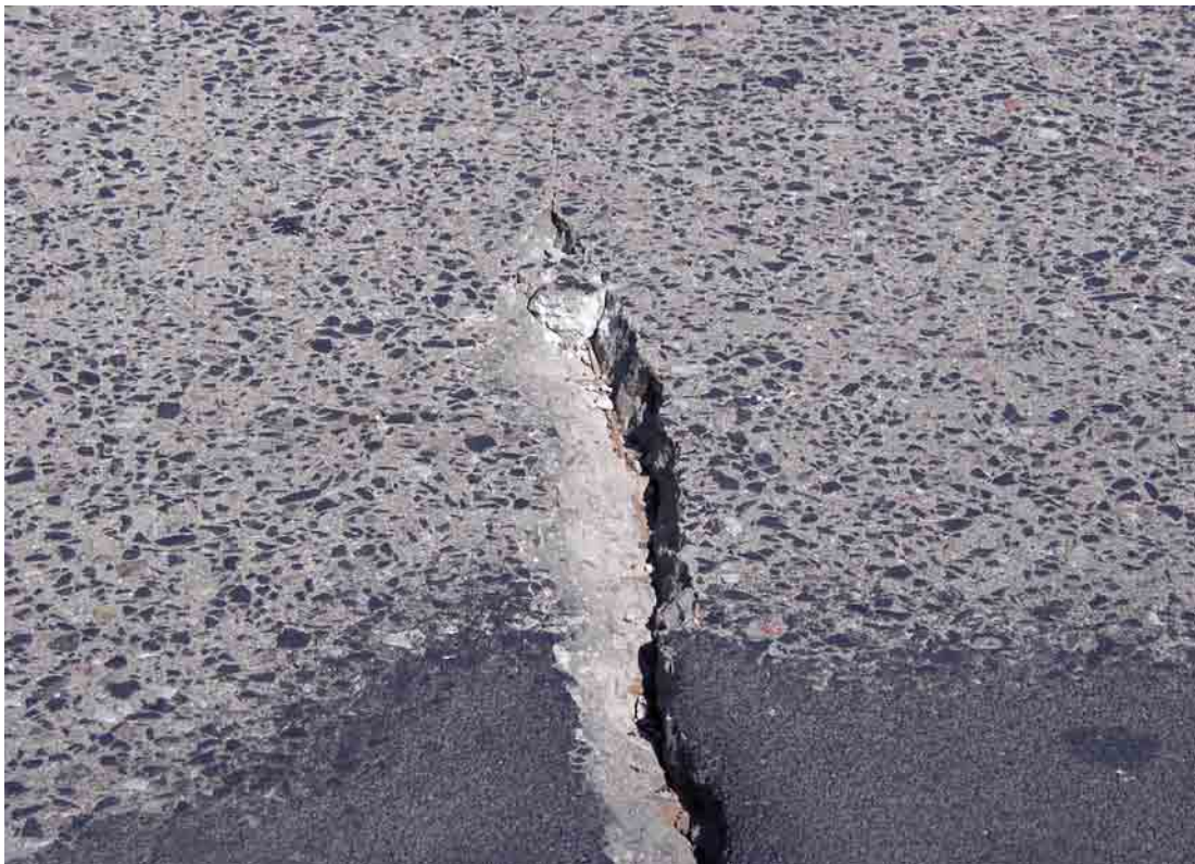
Fot. 28. Pęknięcie z odsłoniętym zbrojeniem (UZ)
