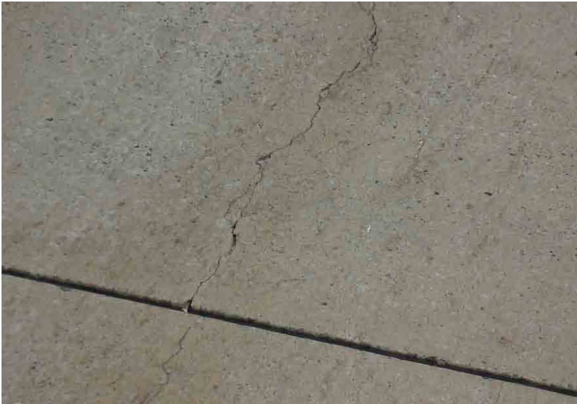
Fot. 2. Pęknięcie podłużne małej szkodliwości przebiegające przez na dwie kolejne płyty (PL)
