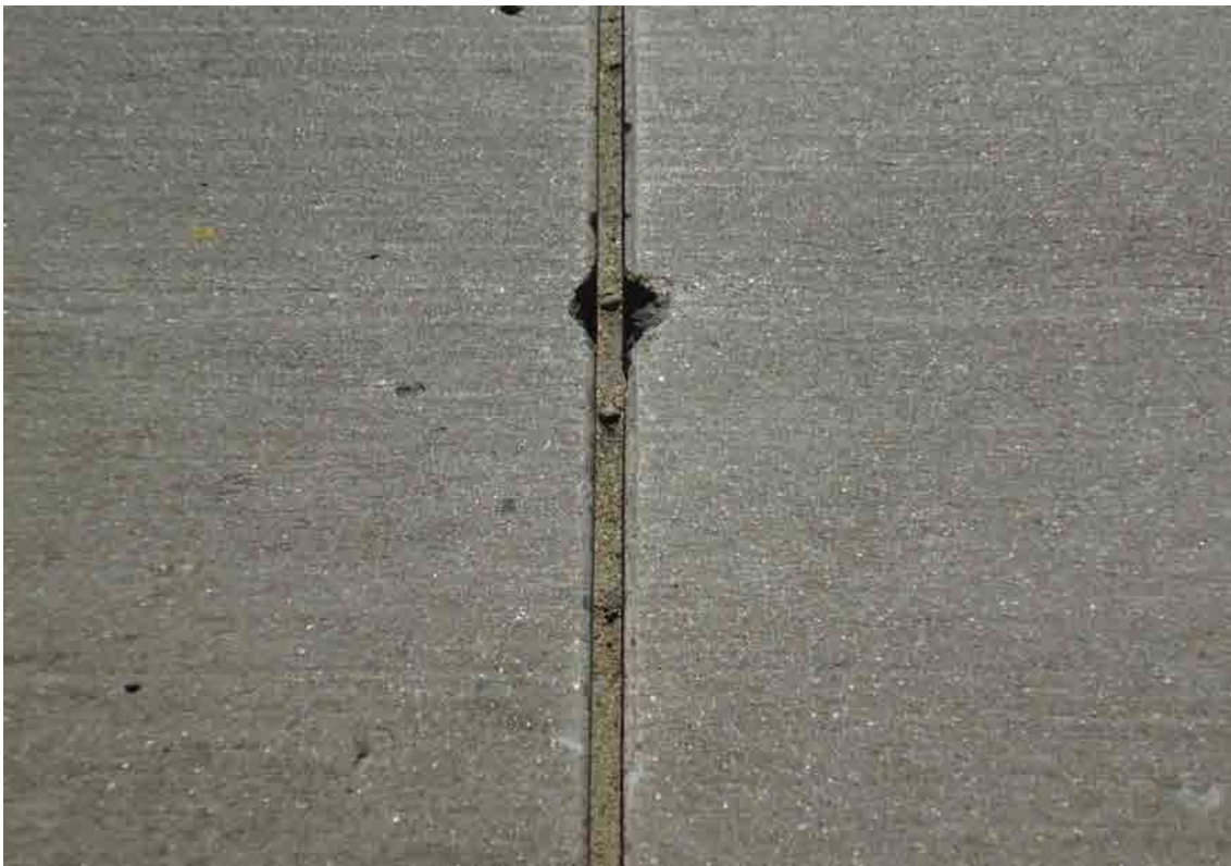
Fot. 47. Wykruszenie szczeliny o małym stopniu szkodliwości na obydwu sąsiadujących płytach (WS)
