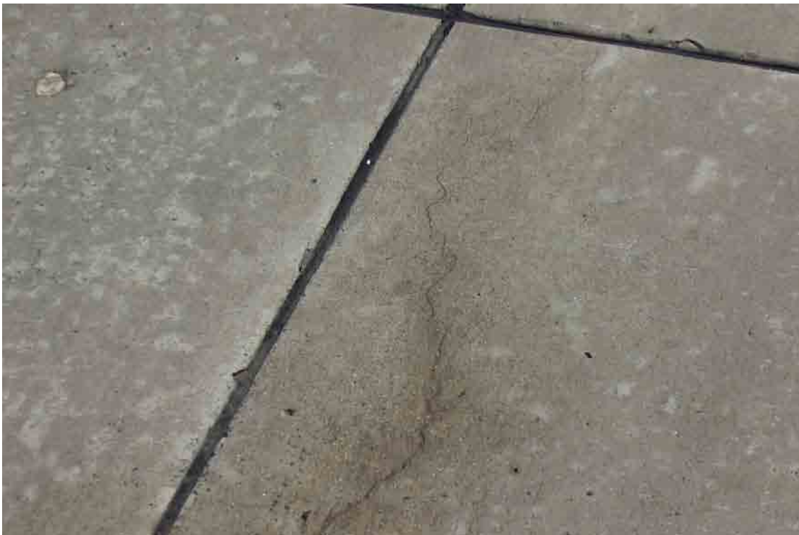
Fot. 18. Pęknięcie przy krawędzi o małej szkodliwości (PK)
