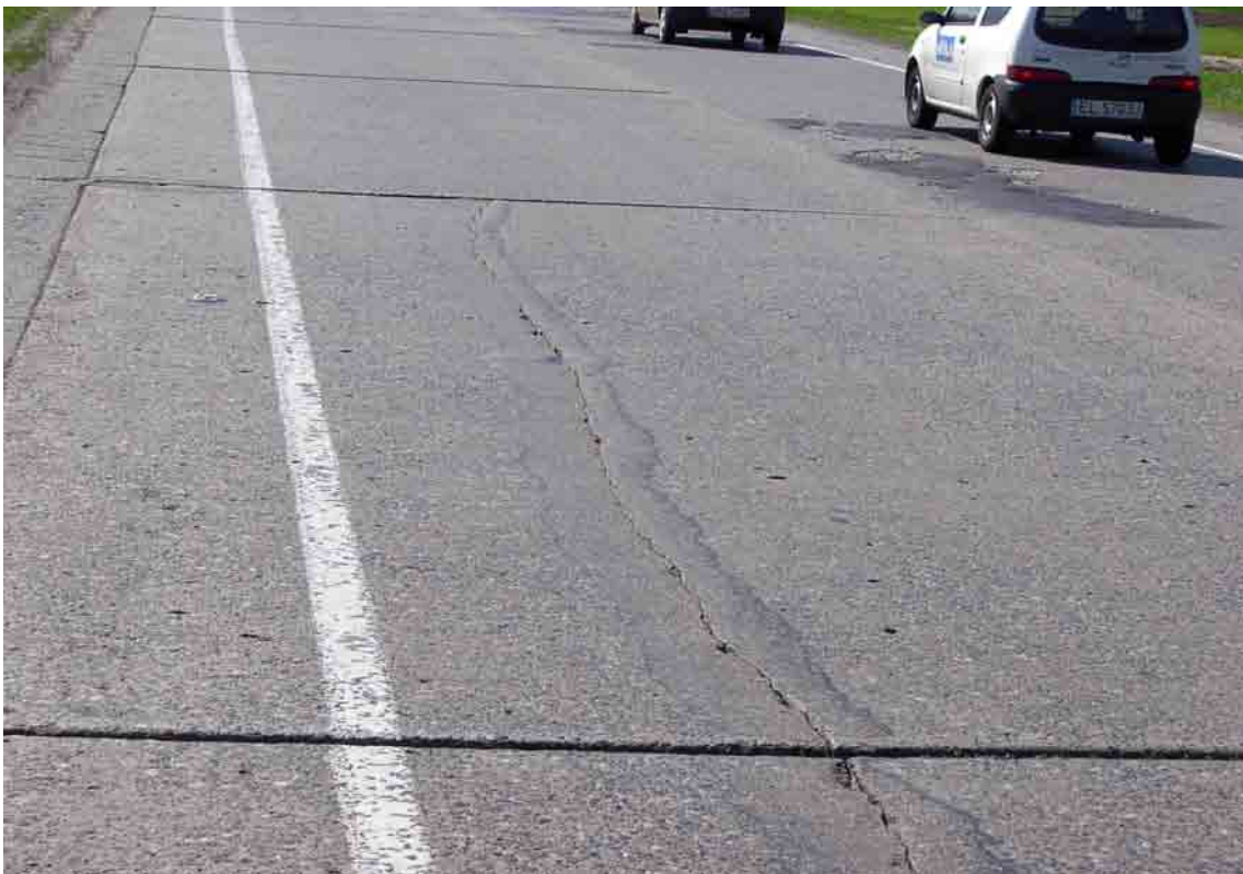
Fot. 7. Kolejny przykład pęknięcia podłużnego o dużej szkodliwości (PL)
