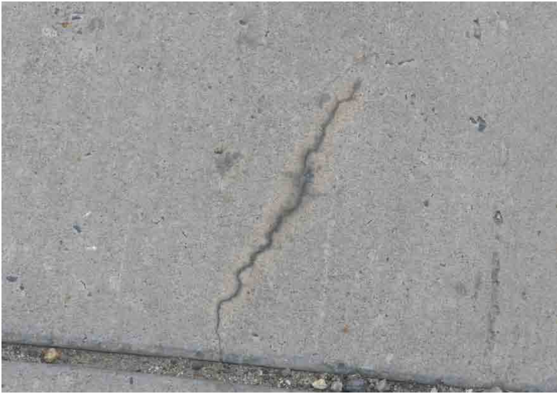
Fot. 4. Inny przykład pęknięcia podłużnego o małej szkodliwości (PL)
