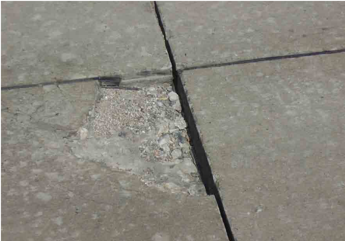
Fot. 46. Wykruszenie narożnika o dużym stopniu szkodliwości (UN)
