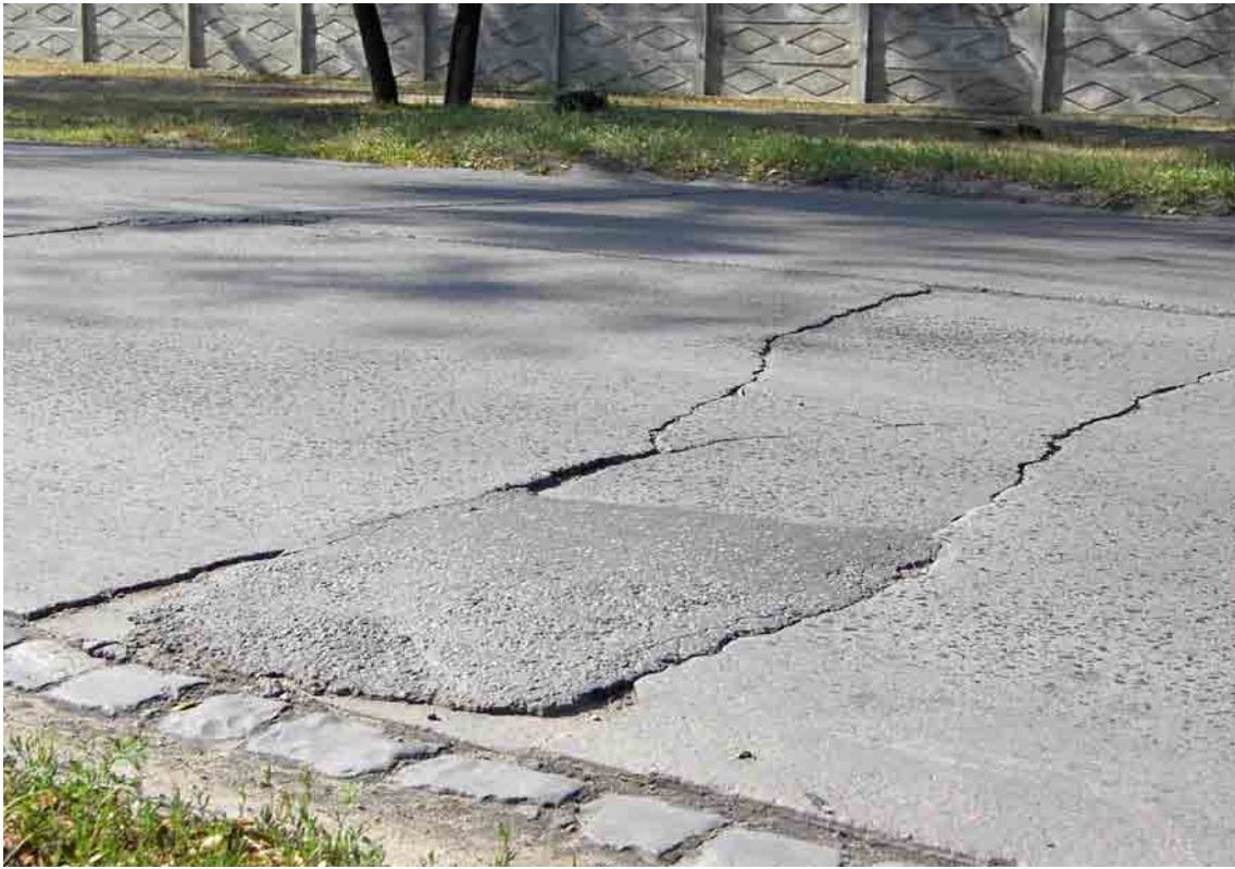
Fot. 16. Inny przykład połamanej płyty, dodatkowo łąta bitumiczna (BS) (LA)
