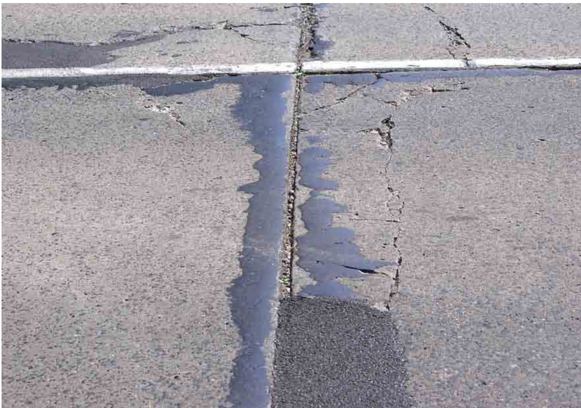
Fot. 27. Liczne spęknięcia przy krawędzi płyty wraz z widoczną łąką bitumiczną oraz bitumicznym uszczelnieniem (PK)
