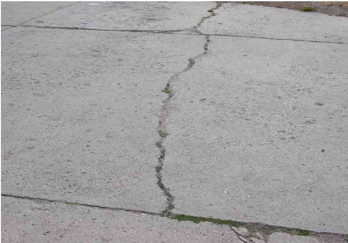
Fot. 15. Przykład połamanej płyty – płyta podzielona na 4 części (BS)
