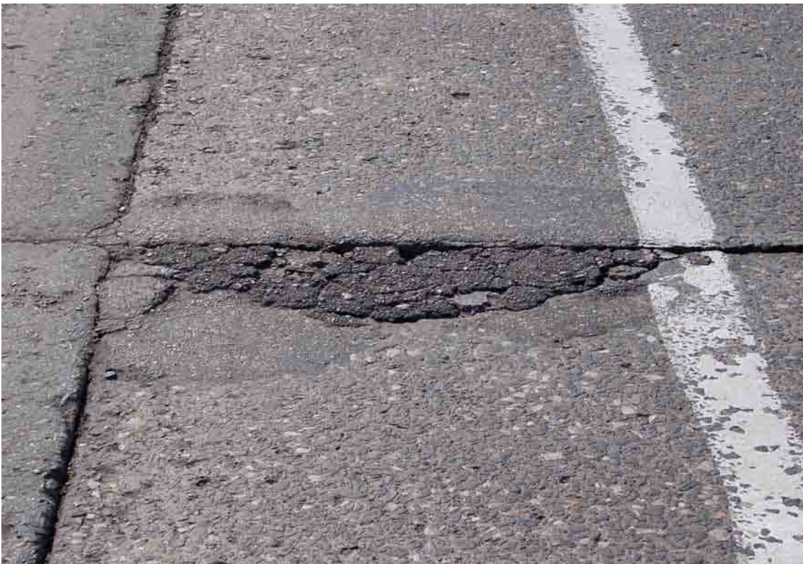
Fot. 23. Pęknięcia przy krawędzi pokryte popękaną łątą bitumiczną ( PK )
