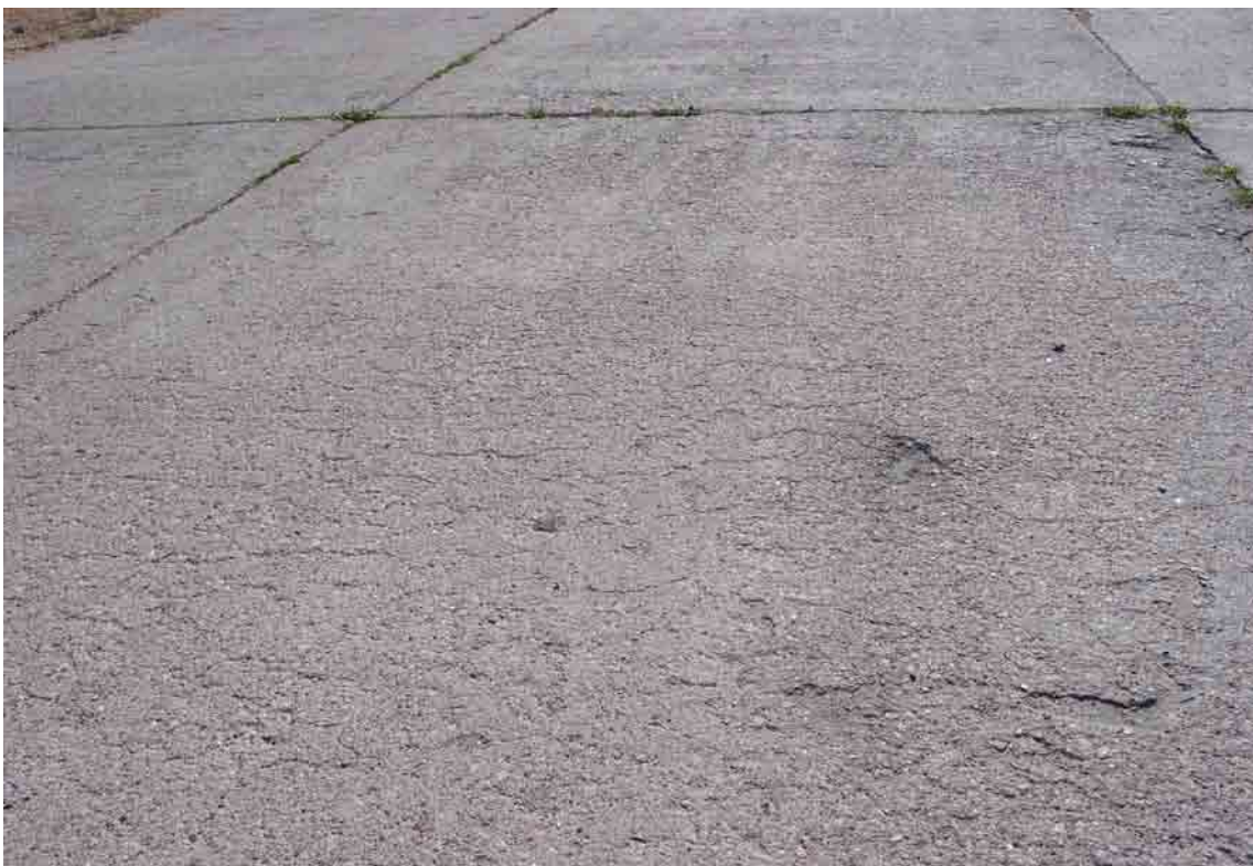
Fot. 61. Kolejny przykład złuszczenia powierzchni (UP)
