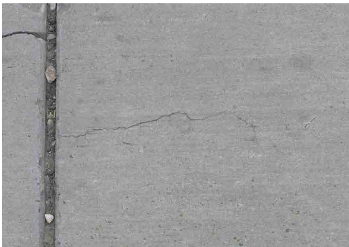
Fot. 39. Wadliwe uszczelnienie, wypełnione kamieniami, dodatkowo pojawiające się pęknięcia podłużne małej szkodliwości (WU)
