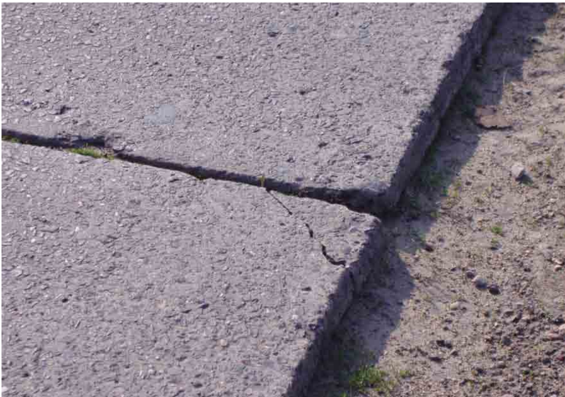
Fot. 40. Pęknięcie narożnika o małej szkodliwości (UN)
