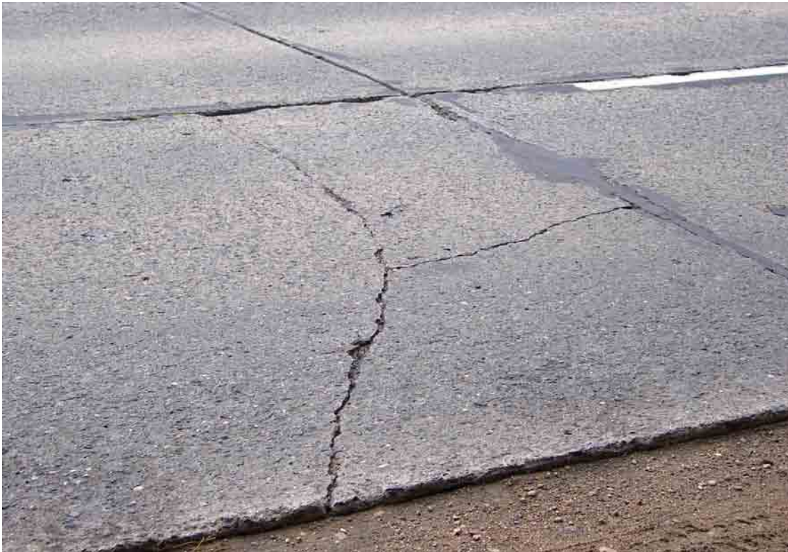
Fot. 13. Pęknięcie poprzeczne oraz podłużne o dużej szkodliwości (płyta rozłamana na trzy części, nie kwalifikuje się jako płyta połamana) (PT) , (PL)
