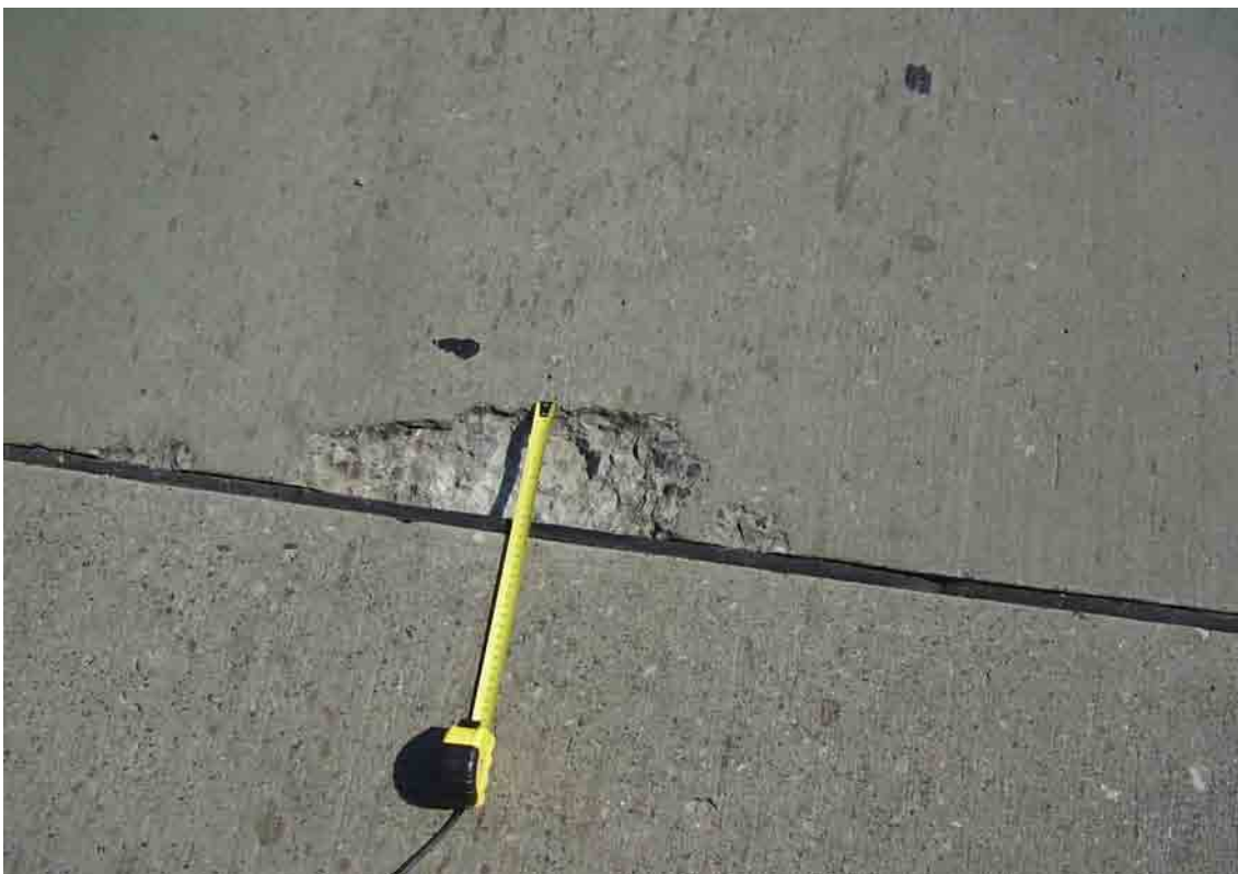
Fot. 51. Odłamanie fragmentu krawędzi płyty (WS)
