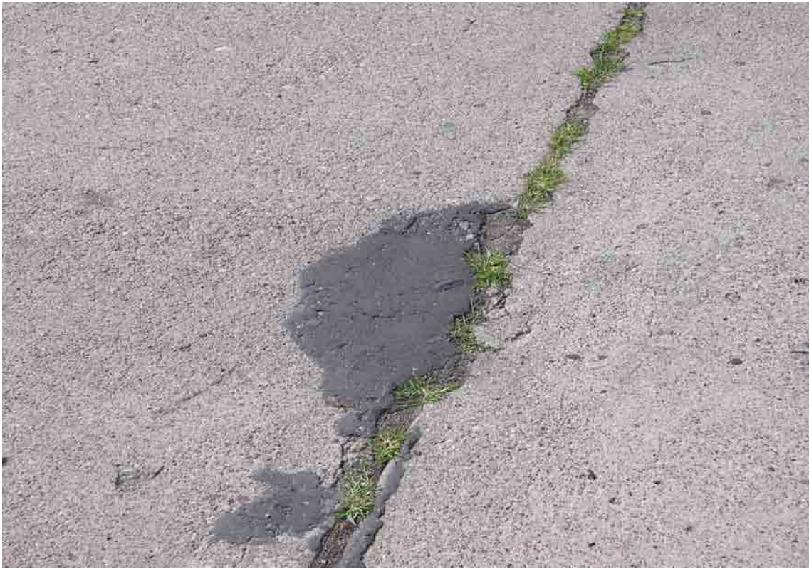
Fot. 36. Kolejny przykład uszczelnienia porośniętego trawą (WU)
