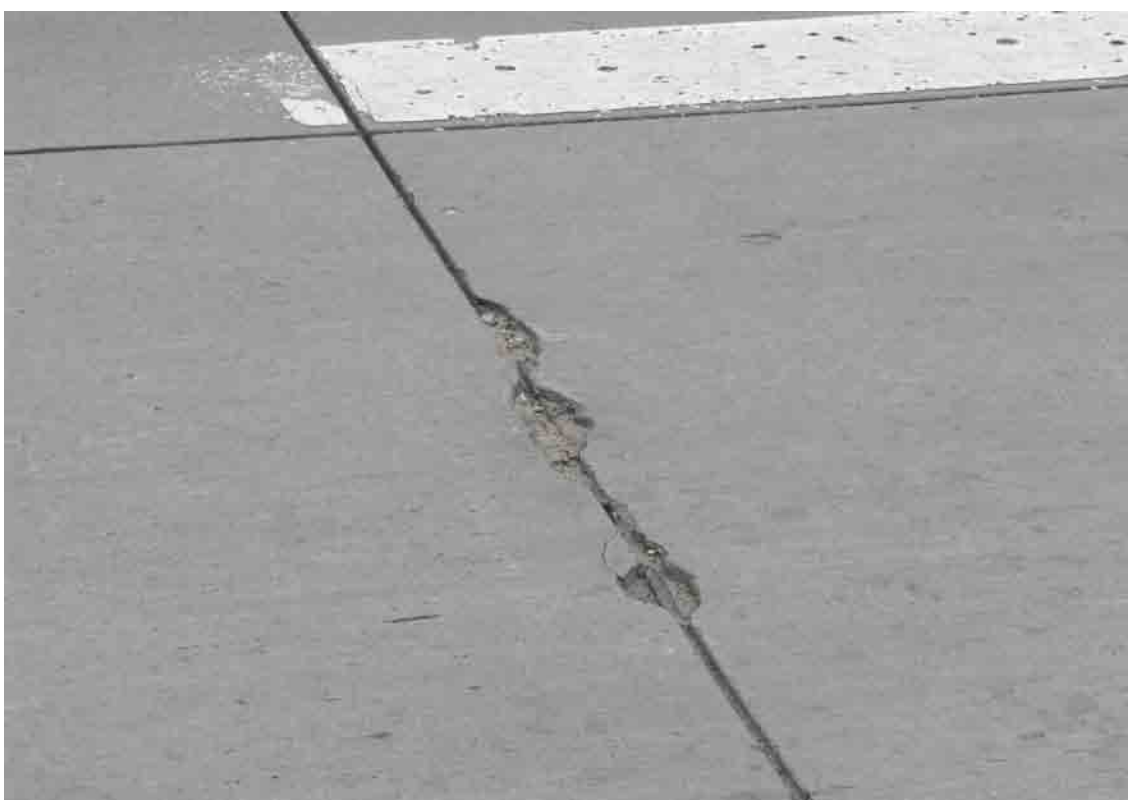
Fot. 54. Wykruszenia szczeliny o dużym stopniu szkodliwości
