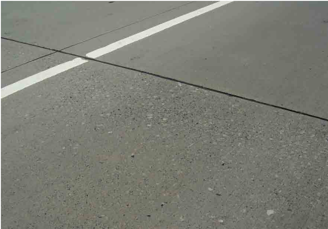
Fot. 55. Ubytek powierzchni płyty (UP)
