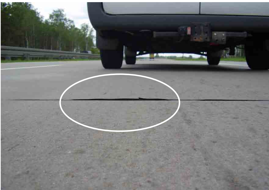
Fot. 33. Uszczelnienie wypychane, odklejone od brzegów płyt (WU)
