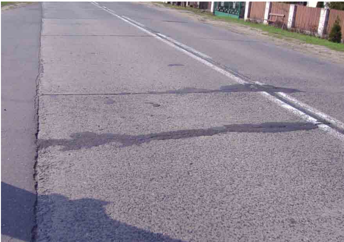
Fot. 10. Pęknięcie poprzeczne o małej szkodliwości pojawiające się mimo wykonania uszczelnienia asfaltowego (PT)
