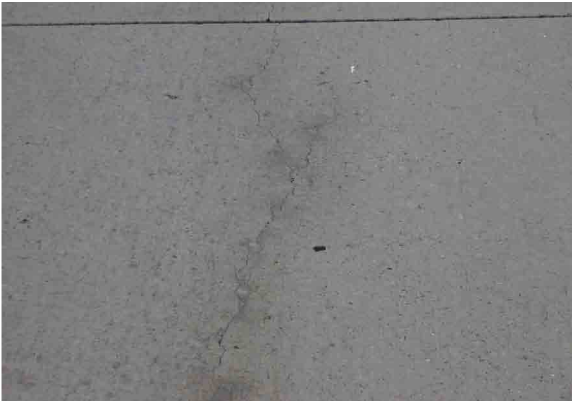
Fot. 3. Pęknięcie podłużne i ukośne o małej szkodliwości (PL)
