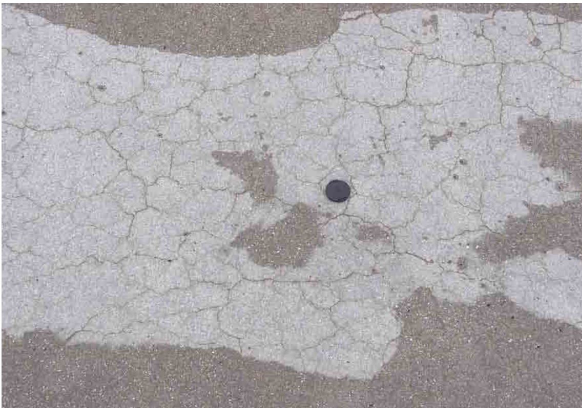
Fot. 59. Siatka pęknięć na powierzchni płyty (UP)
