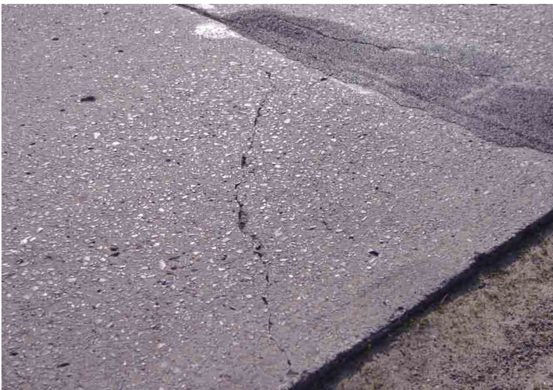
Fot. 41. Pojedyncze pęknięcie narożnika bez wykruszeń (UN)
